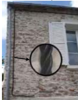
Réseau fils isolés façade BT
