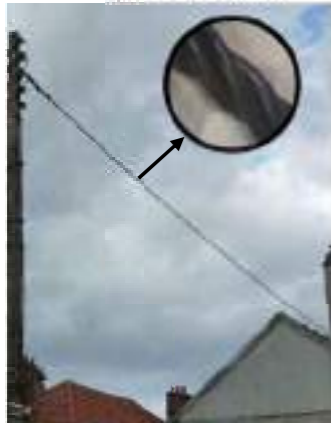
Réseau fils isolés aérien BT
